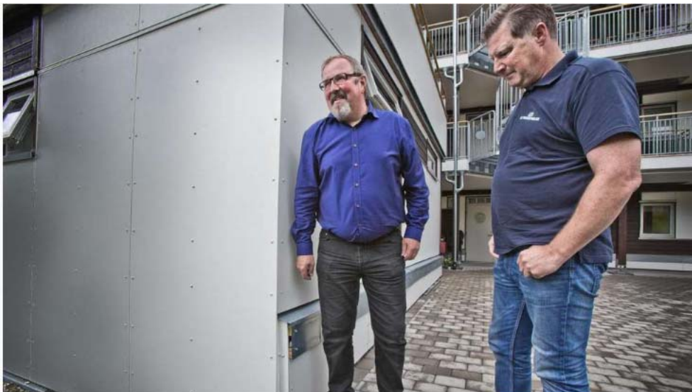
Blikkenslagerne Sture Johansen (t.v.) og Tore Waagenes mener dårlig håndverk vil gi flere modulbygg store problemer innen kort tid. FOTO: JAVAD MONTAZERI, ADRESSEAVISEN
